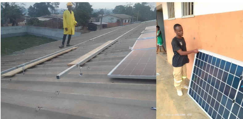
Die Solaranlage in der Schule St. Joseph in Awae muss noch fertiggestellt werden.
